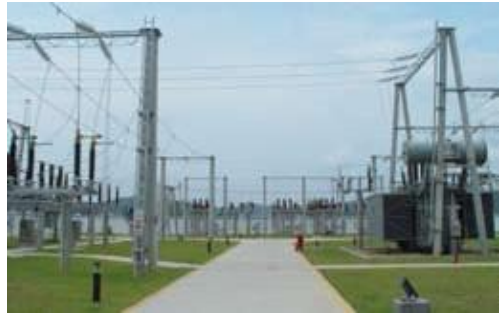
图7-6 回龙110千伏变电站
