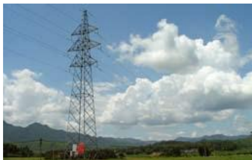
图7-7 改造后的农网线路
